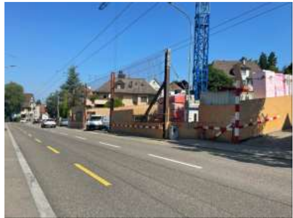
Abbildung 2: Schutzwand, ausgeführt mit engmaschigem Netz, B.3
